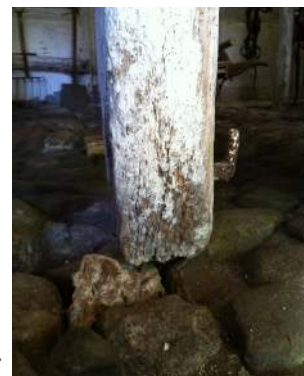
Rötskadad stolpe i stall.
