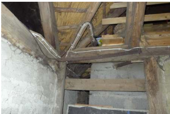
Anslutning portalänga/lolänga sett från lolängen. Notera arkivväggen murad av lecasten.
