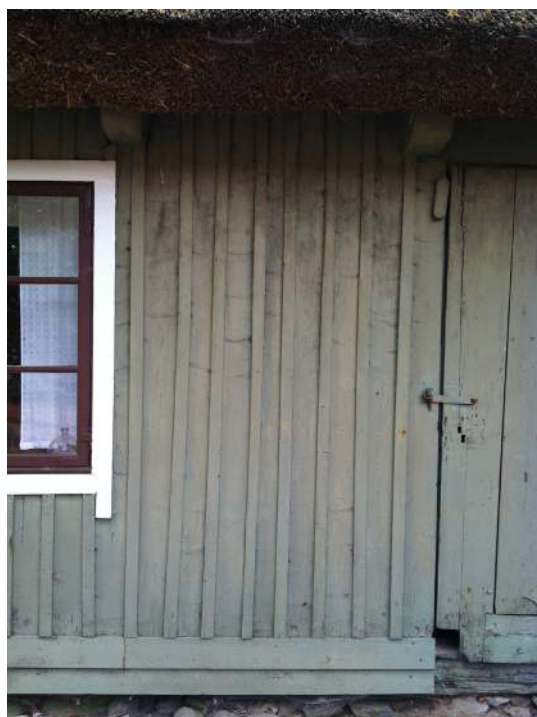
Fasadpanel i behov av ommålning.
