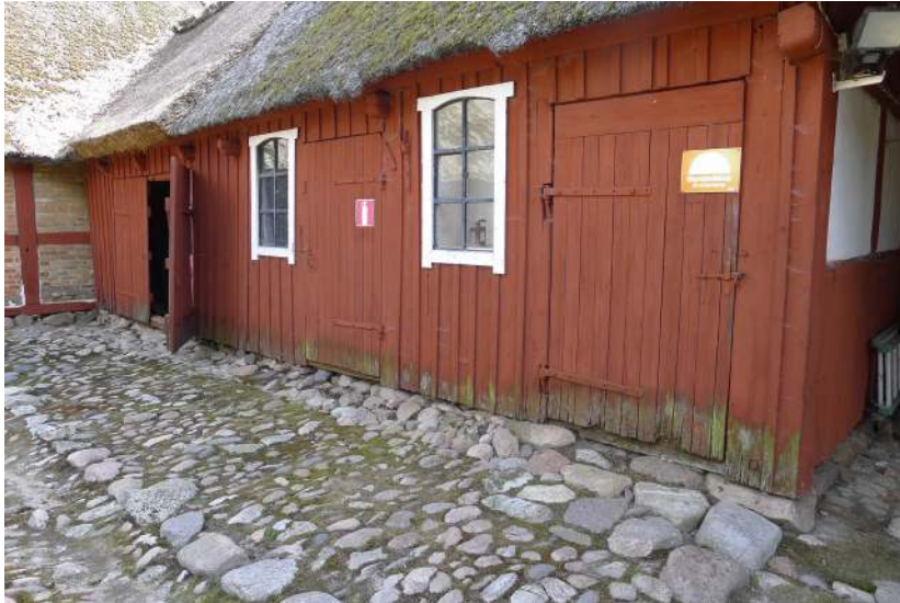
Vägg och portar utanför arkiven. Här går rötskadorna högt upp.
