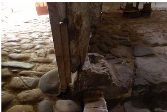
Ej fungerande lagning på bärande stolpe i häststallet.
