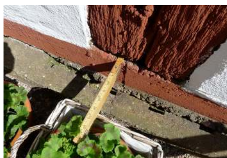
På södra gaveln pågjutning med betong. Hål efter tidigare läkt. Stolpe rötangripen i underkant.
