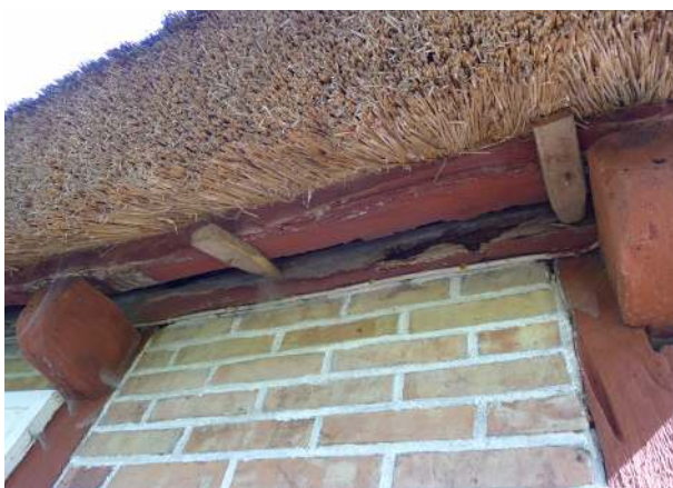
Skadad lejd på södra fasaden.
