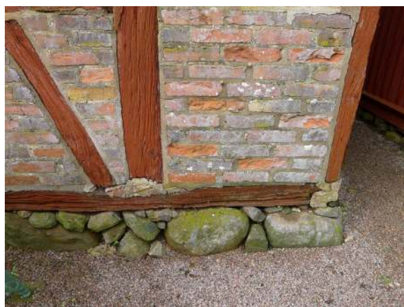
Kvarstående skador på stallängans södra gavel.
