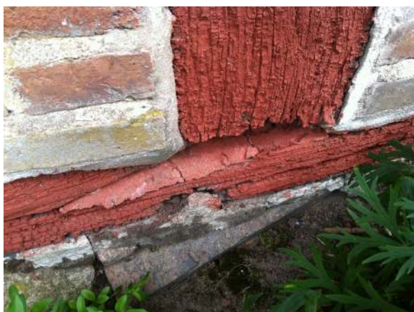
Fotträ lagat med cementbruk på södra fasaden.
