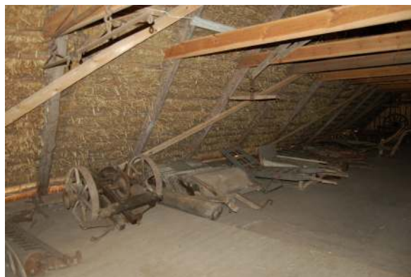
Tunga redskap på vind belastar mellanbjälklag.
