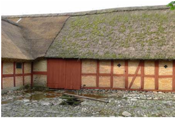
Fasad mot gården i hörnet mot stalllängan. Vattnet samlas i hörnet efter regn. Porten är rötskadad i nederkant.
