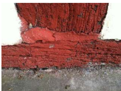
I bildens nedre del syns den pågjutna sockeln av betong. Mellan fotträ och stolpe lagning med bruk.
