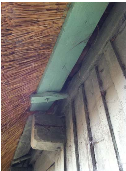
Nymålad gesims i fel kulör.
