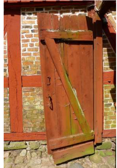
Port mellan boningslängorna. Även konstruktionen rötskadad.
