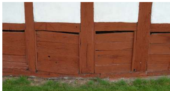
Till vänster. Skador i bålevägg.
