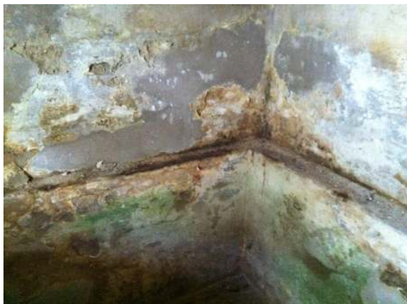
Putsskador på innerväggar.
