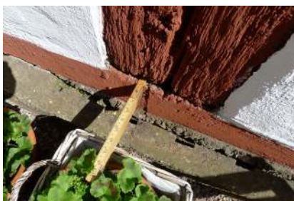
Stolpe mot betong rötskadad.
