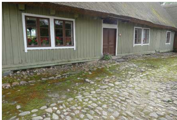
Dålig avrinning på grund av organiskt material i rännan.
