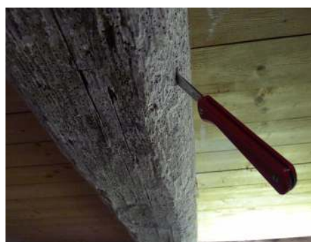
Skador kontrolleras genom knivstick.
