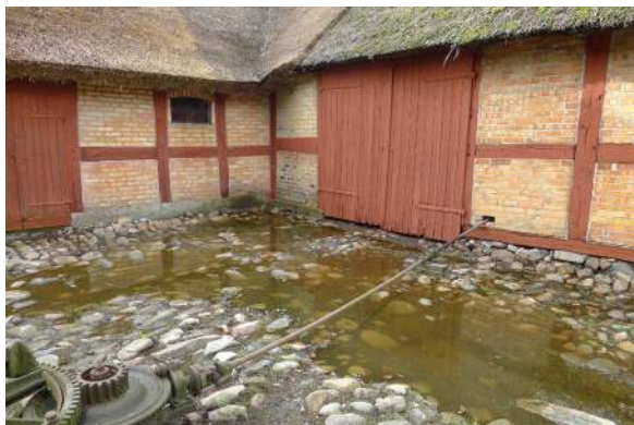
Vattenansamling i hörnet av lolängan och stallängan på grund av deformationer i ränndalarna.
